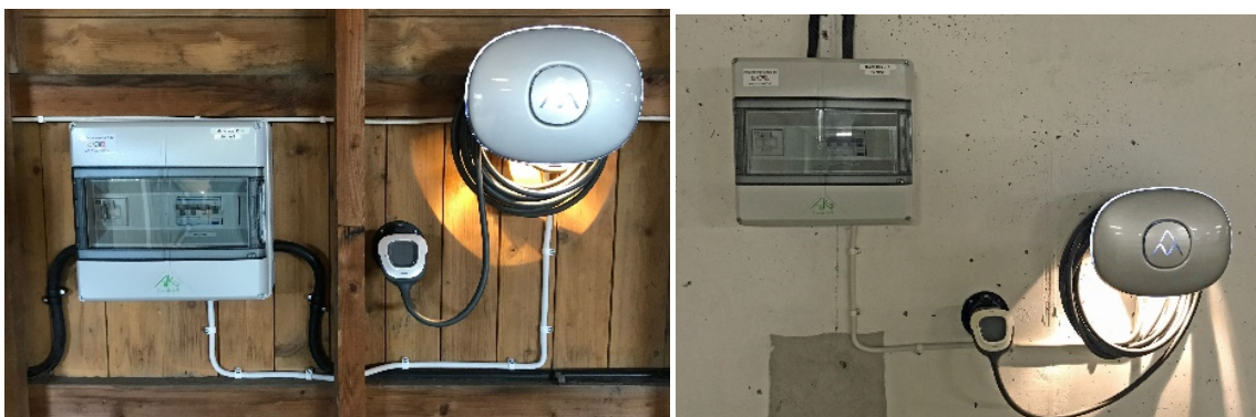
Laddboxar och kapsling/kopplingsdosa inkl. huvudbrytare och automatsäkring.
